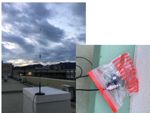
図 4 屋上に設置したセンサノード
